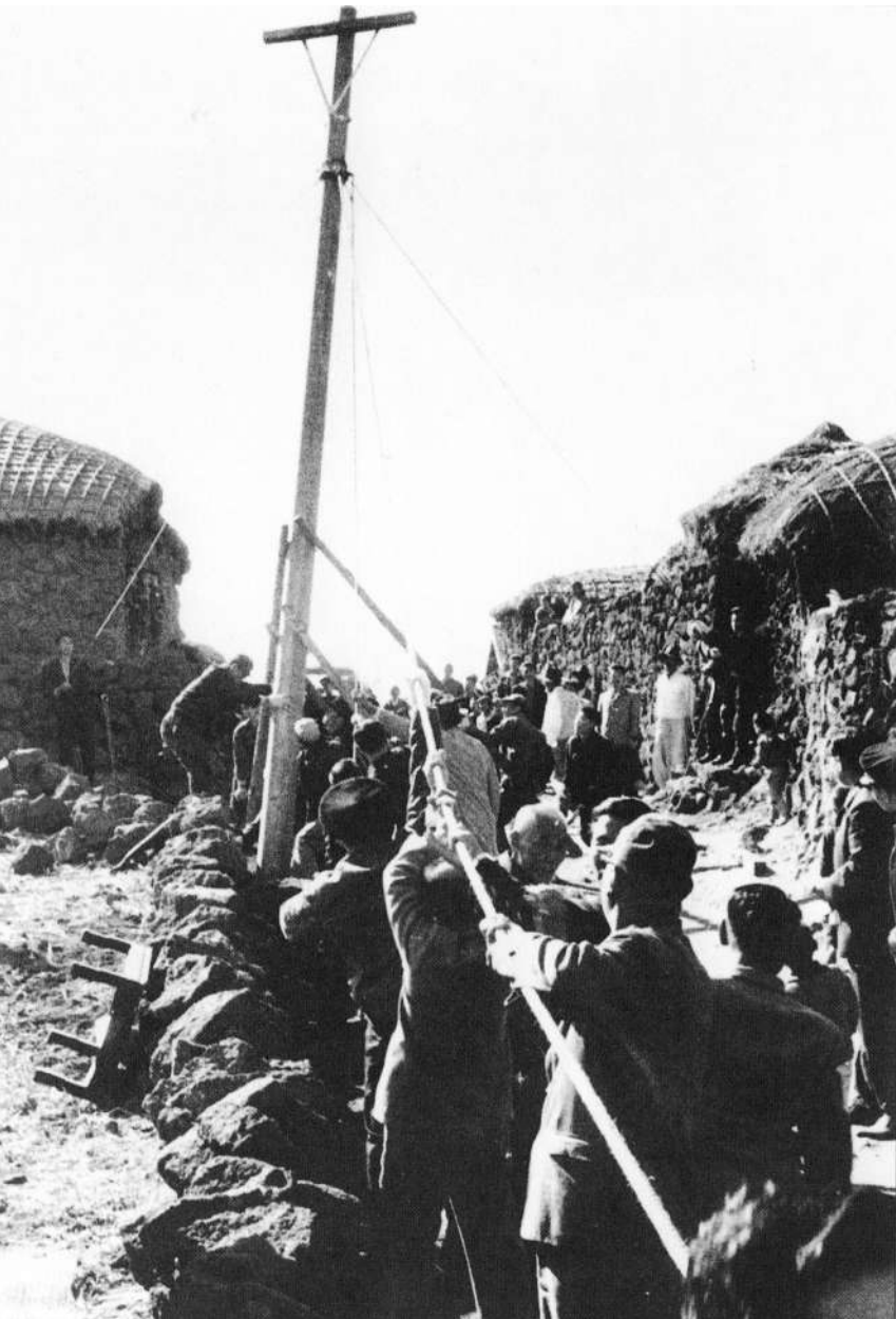
전기가설을 위해 전주를 세우는 모습. 새미마을의 전기가설공사 모습도 크게 다르지 않았을 것이다. <사진출처 : 《사진으로 엮은 20세기 제주시》/제주시>
