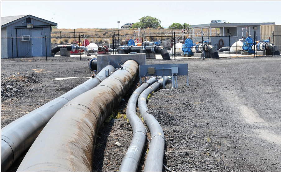
〈그림〉 직경이 1.4m에 이르는 넬하의 해양심층수 취수 파이프라인
