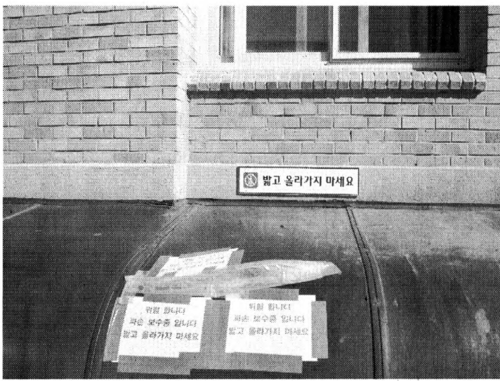
출입통제시간을 맞추지 못한 학생들이 고시원 지붕을 밟고 창문을 통해 들어가려다가 지붕 유리창이 파손되고 말았다.
