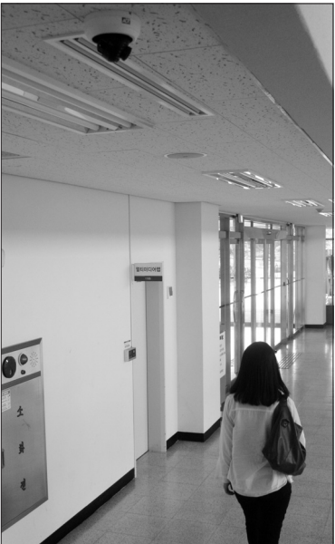
인문대학 2호관 중앙현관에는 사각지대를 줄이기 위해 추가로 CCTV가 설치됐다.
