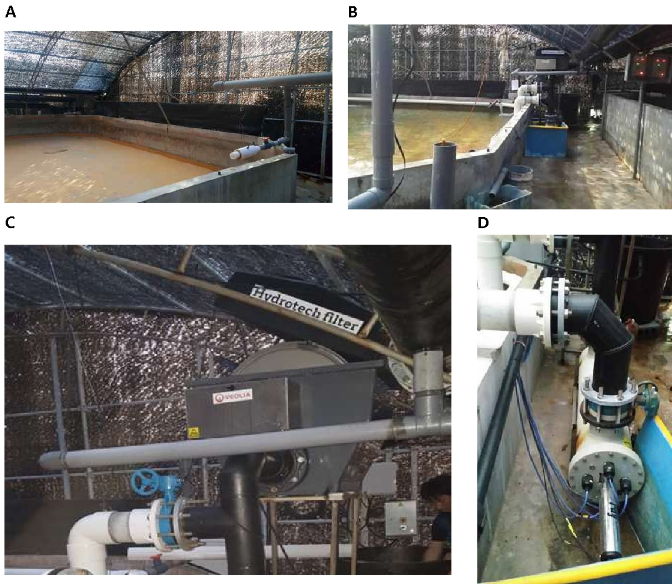
그림 1. 드럼필터여과-자외선살균시스템 설치 사진
