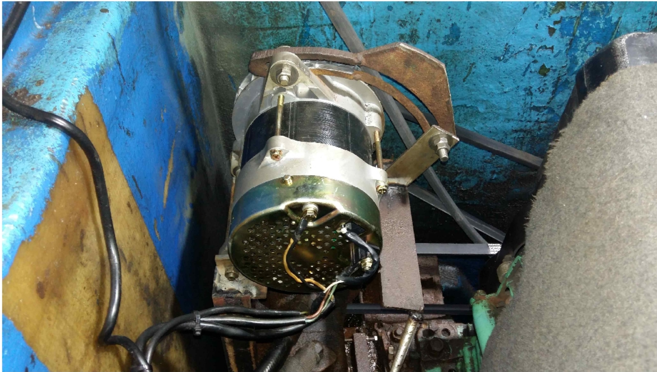
그림 4. 기관실 안에 설치한 제너레이터
